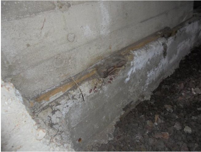
Bild 18. Under tamburen i krypgrunden finns formvirke kvar mot betongsula, dessa löper hög risk för mikrobiella skador som kan belasta inomhusluften via otätheter i golvbjälklag.
