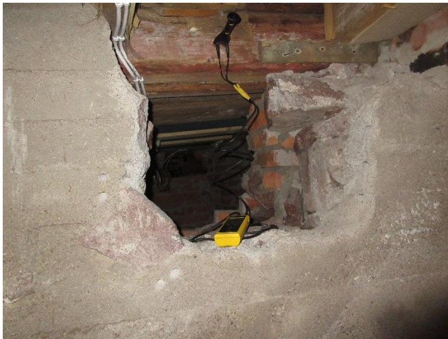
Bild 10. Mätning av fuktkvot i bärande balk. Fuktkvoten låg på 26 v%, vilket medför en risk för mikrob- och rötskador. Vid denna tog materialprov nummer 1 som indikerar på mikrobiella skador i bjälklaget.
