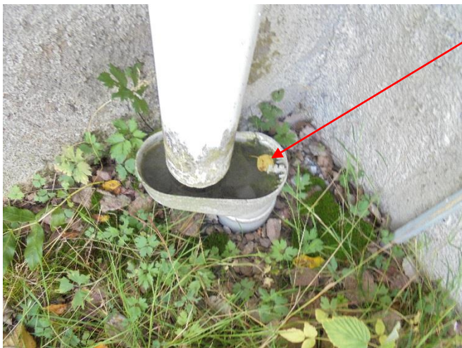
Bild 4. Regnvattensystemets delar bör rengöras regelbundet.
