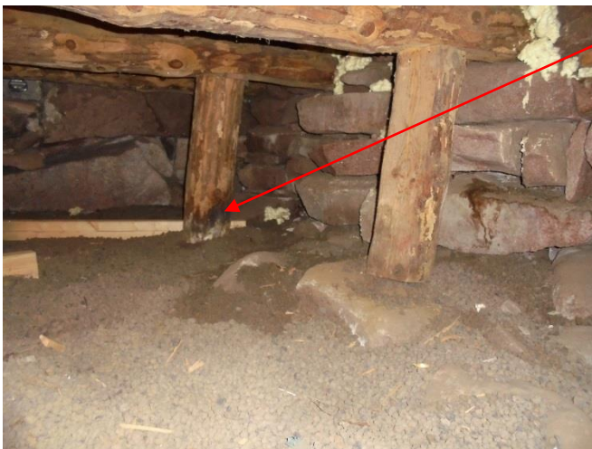
Bild 19. Rötskada på stöd för balkar.
