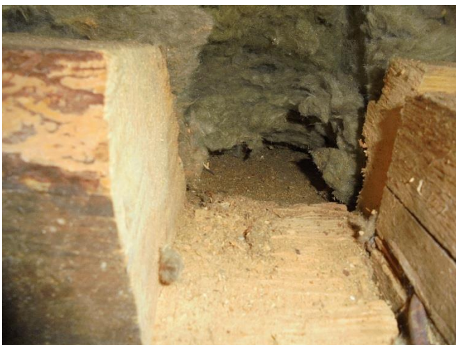
Bild 20. Under salen i husets norra del finns delvis ett icke-tillgänglig del i kryputrymmet som okulärt sett från kryputrymme är isolerad med mineralull men vid håltagning och provtagning i golv i utrymmet konstaterades golvet vara isolerat med cellulosaisolering, gränsdragning mellan golvtyper är uppskattad på planritning.
