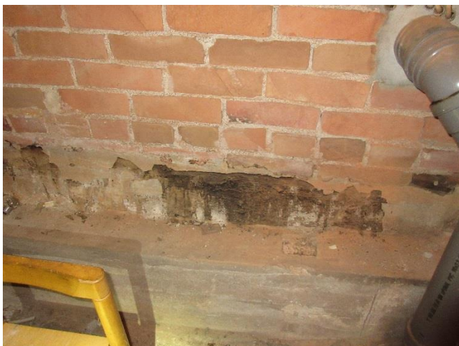
Bild 14. En stenkolsstjära innehållande PAH-föreningar observerades i källaren.
