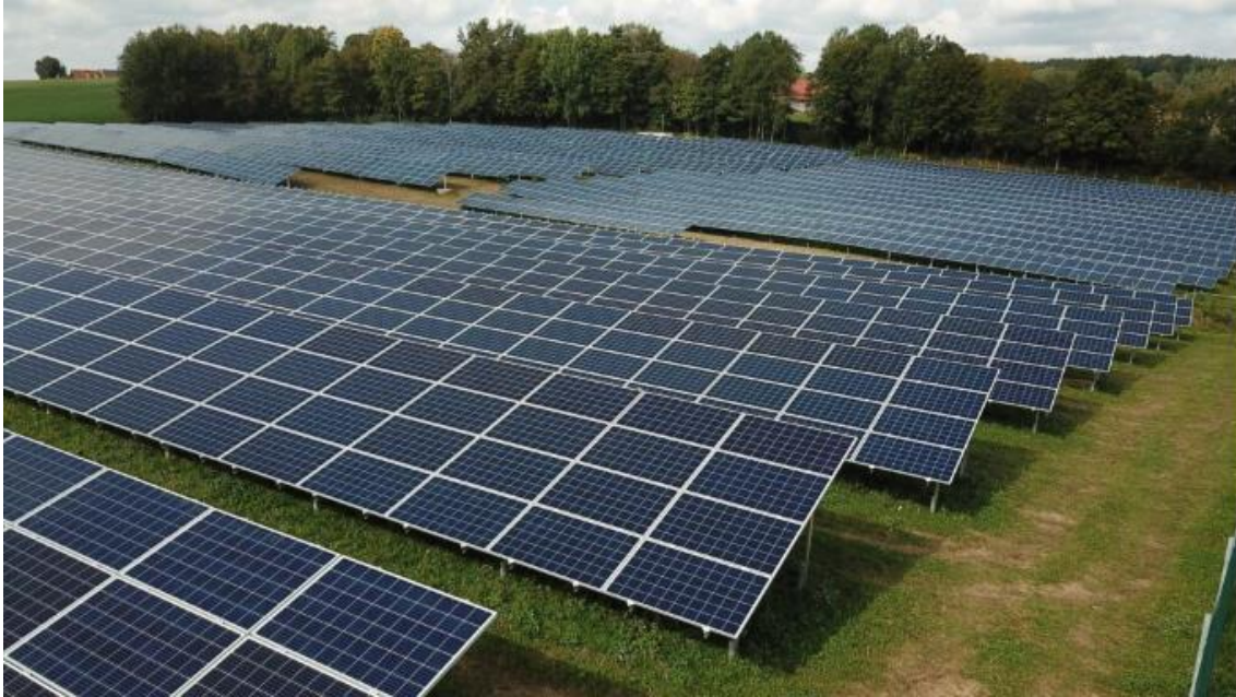
Figur 6. Exempel på montering av solpaneler för anläggning på mark
