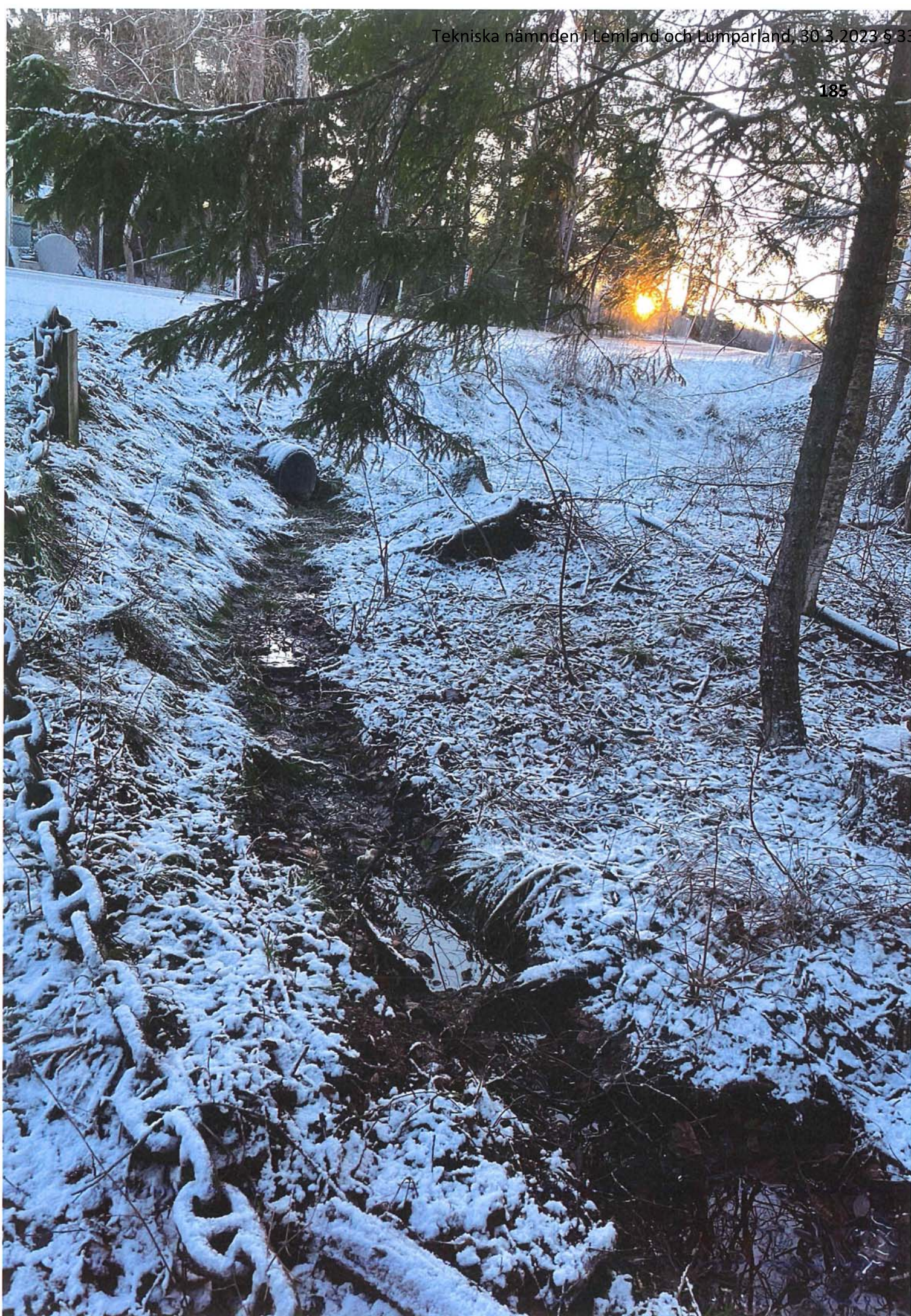
Vägtrummans utlopp där tillrinningen kommer till min fastighet 2st bilder
